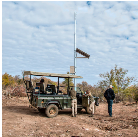
Figuur 5: Een LoRa-toren in Welgevonden Game Reserve (Zuid-Afrika). De 'poort' ('gateway') zit helemaal bovenin. Bovenin is ook een bliksemafleider gemonteerd. De zonnepanelen voeden de accu's die de elektriciteit leveren om de signalen van de bewegende 'waakdieren' dag-en-nacht door te geleiden naar de meldkamer van het reservaat.
